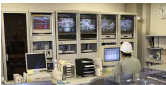
成形工場集中監視室
